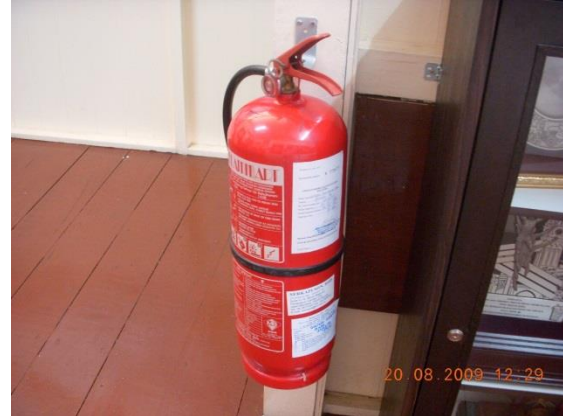
Gambar 5: Hanya pemadam api mudah alih disediakan atas tujuan keselamatan kebakaran dalam bangunan Kajian Kes 3 (Sumber : Penulis)
